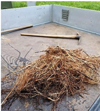
Wurzelwuchs in den Leitungen
